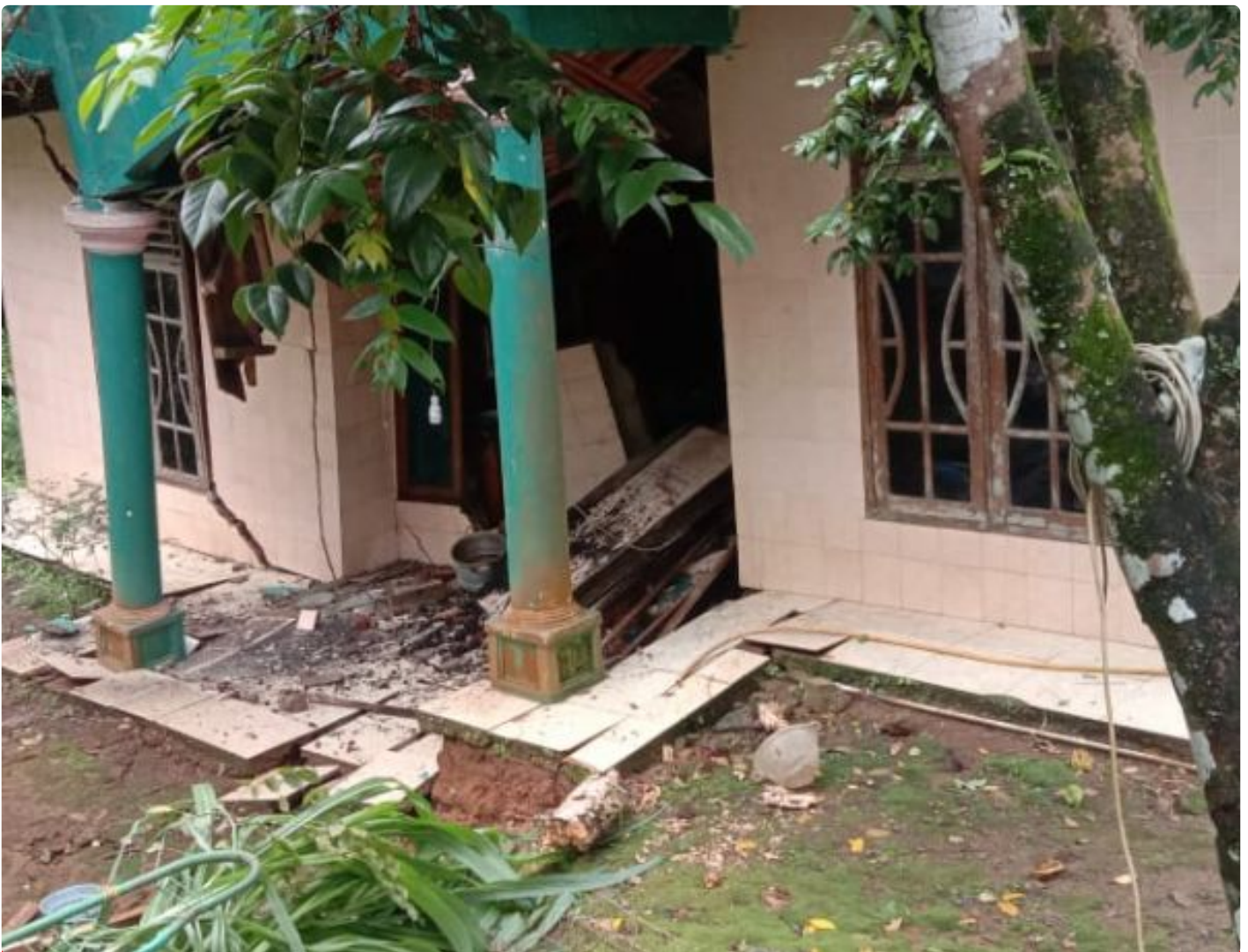
Tampak Rumah warga yang sudah dikosongkan karena Kondisinya yang sudah mau ambruk
